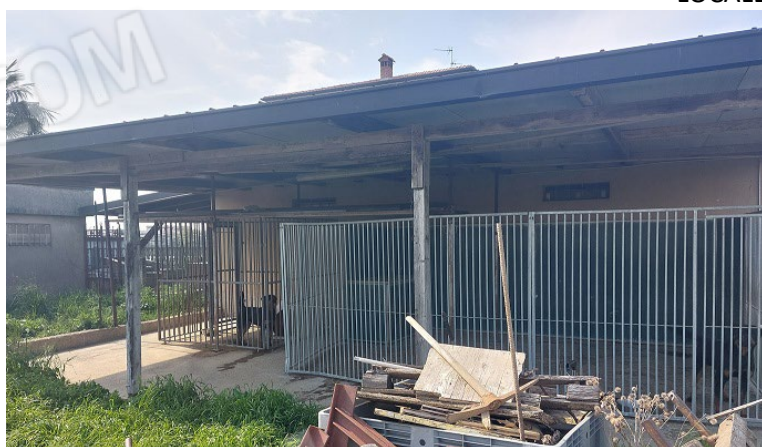
TETTOIA DEPOSITO NON AUTORIZZATA
