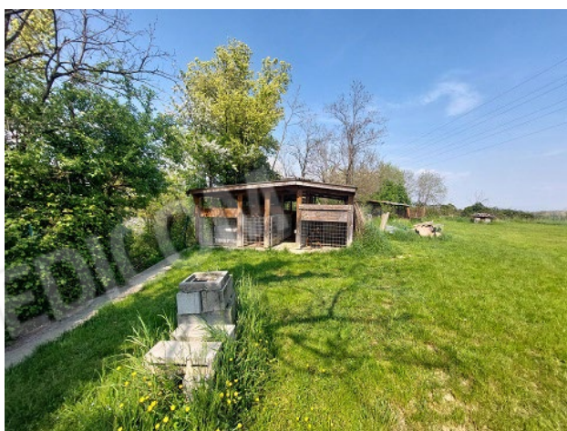
TETTOIE NON AUTORIZZATE ZONA NORD LOTTO
