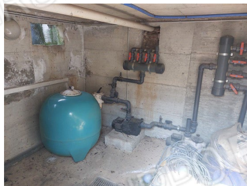
LOCALE TECNICO INTERRATO NON AUTORIZZATO
