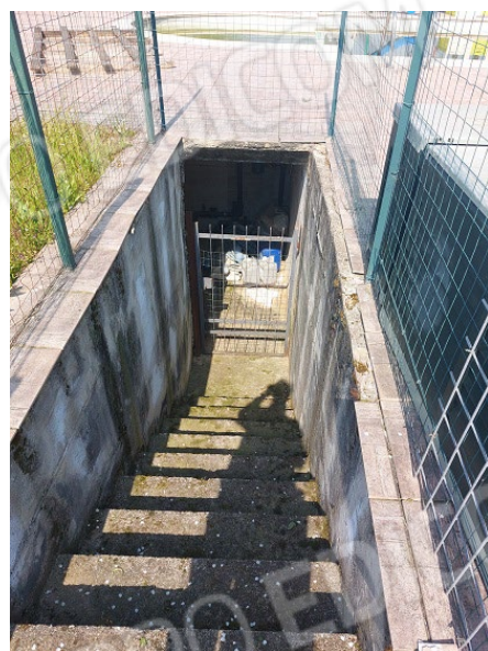
SCALA LOCALE TECNICO INTERRATO NON AUTORIZZATO
