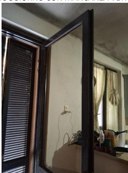
VISTA 1 SOGGIORNO CON MANCANZA VETRO PORTA
