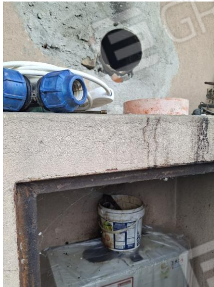
CALDAIA CON MANCANZA COLLEGAMENTO CANNA FUMARIA
