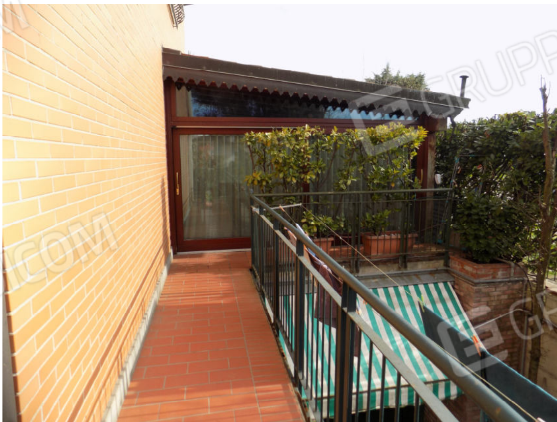
veranda esterna illegittima
