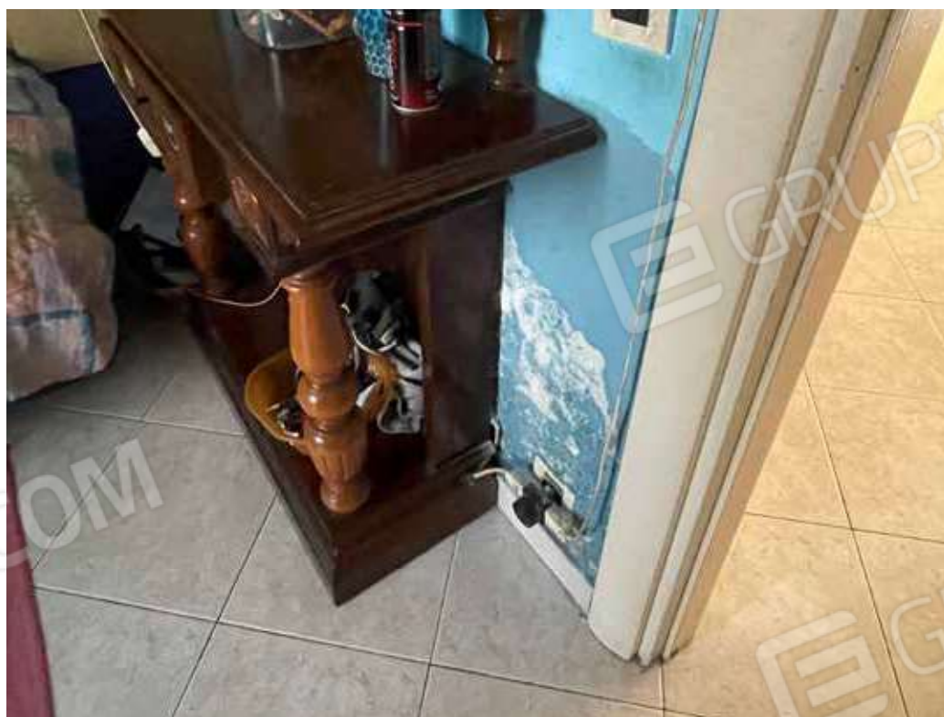
16 Particolare delle infiltrazioni
