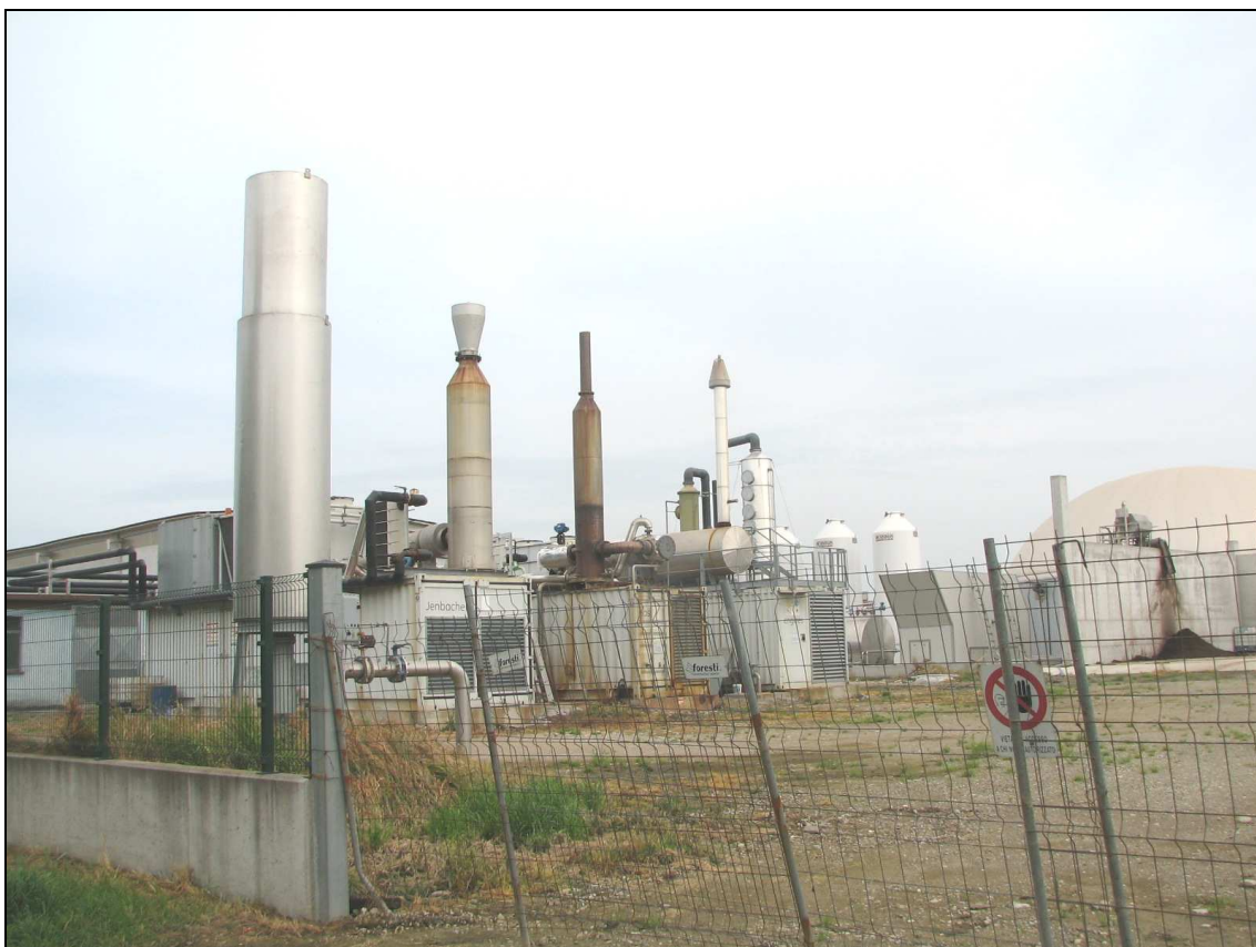
4 - motori di cogenerazione sulla Particella 57
