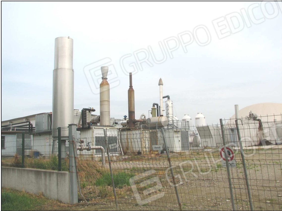
4 - motori di cogenerazione sulla Particella 57
