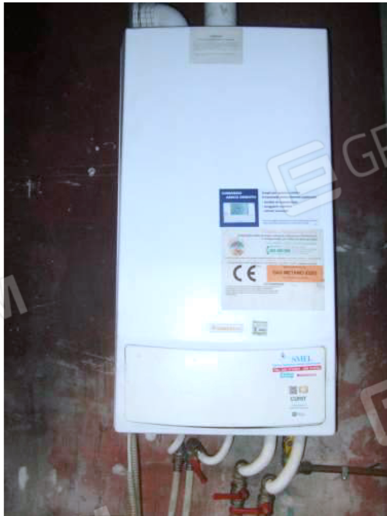
Fotografia n. 30 - Caldaia dell'impianto idrotermosanitario di pertinenza al subalterno 3
