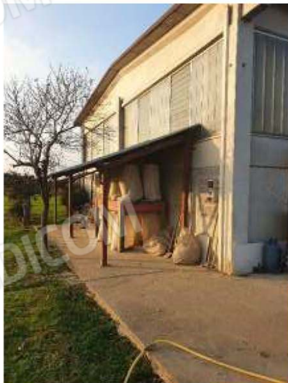
Tettoia non autorizzata in lato sud
