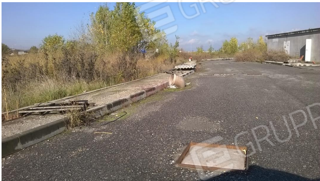
4) Materiale abbandonato e chiusino mancante e cabina enel
