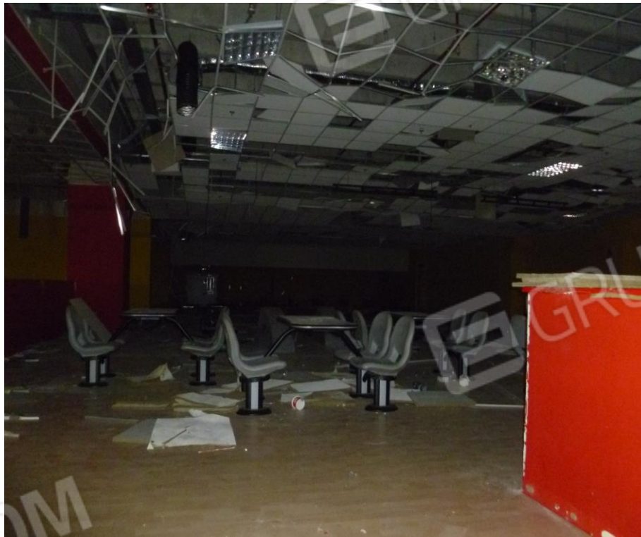
24) Fotografia riprendente il bene CORPO E catastalmente identificato nel Comune di Orzinuovi, fg. 11 mappale 580 (piano primo – ex sala Bowling).
