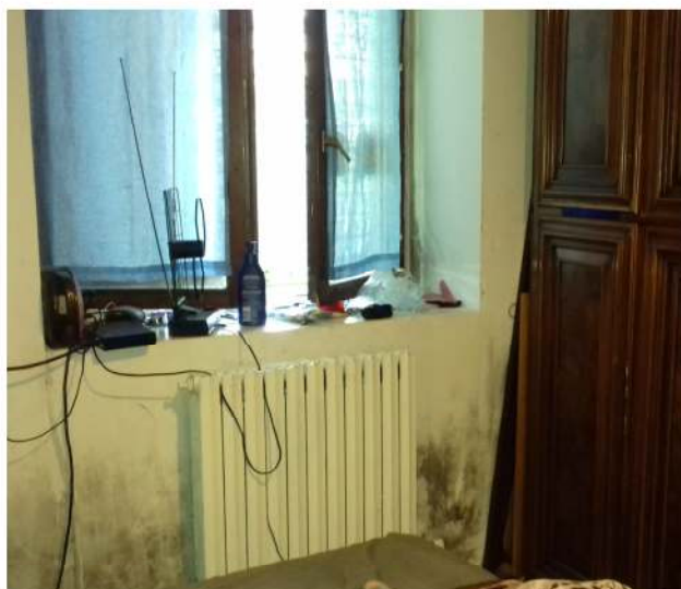
FOTO 9: CAMERA (EVIDENTI FORMAZIONI DI MUFFA – LATO OVEST)
