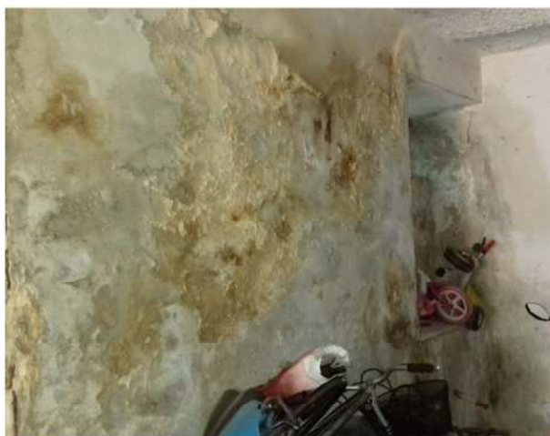
FOTO 11: ZONE COMUNI PIANO INTERRATO – INFILTRAZIONI LATO OVEST
