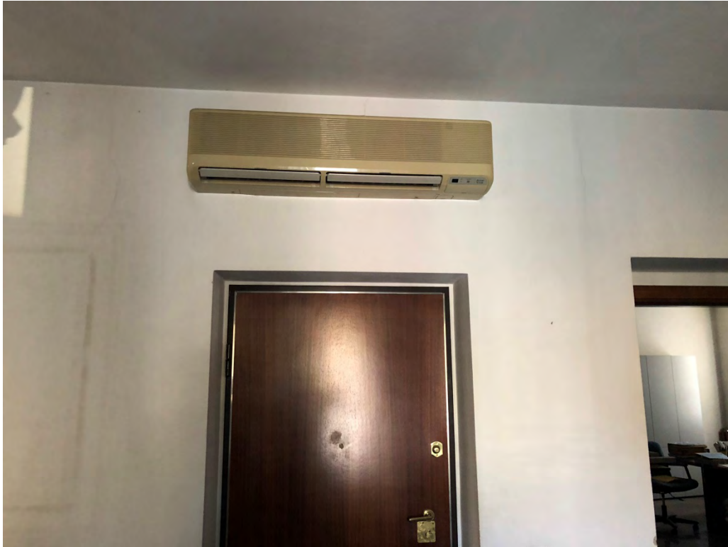
Vista dell'impianto di condizionamento dell'aria
