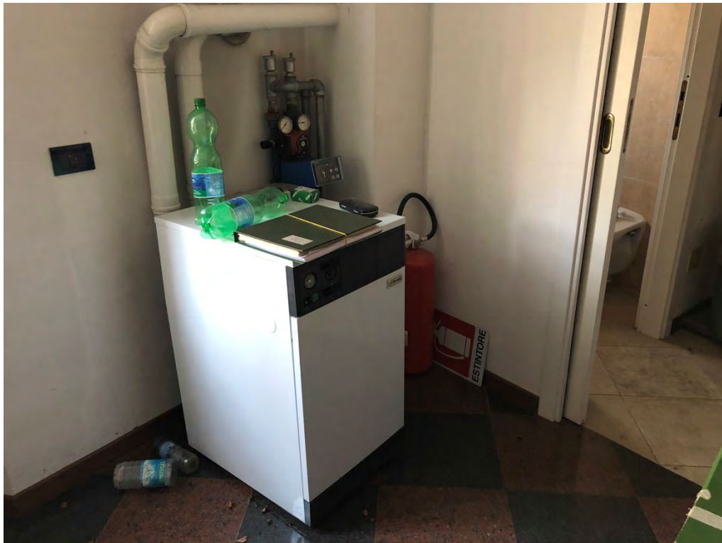
Vista della caldaia interna
