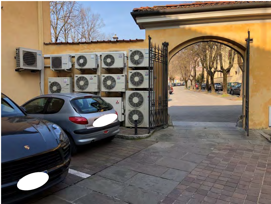
Vista delle pompe di calore collocate all'esterno sul muro della corte confinante
