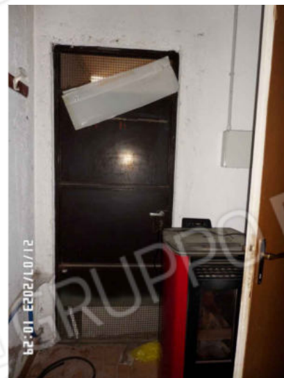
FOTO 43: Porta locale caldaia
