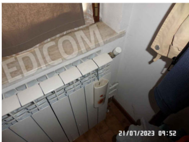
FOTO 44: Particolare calorifero camera al p. terra
