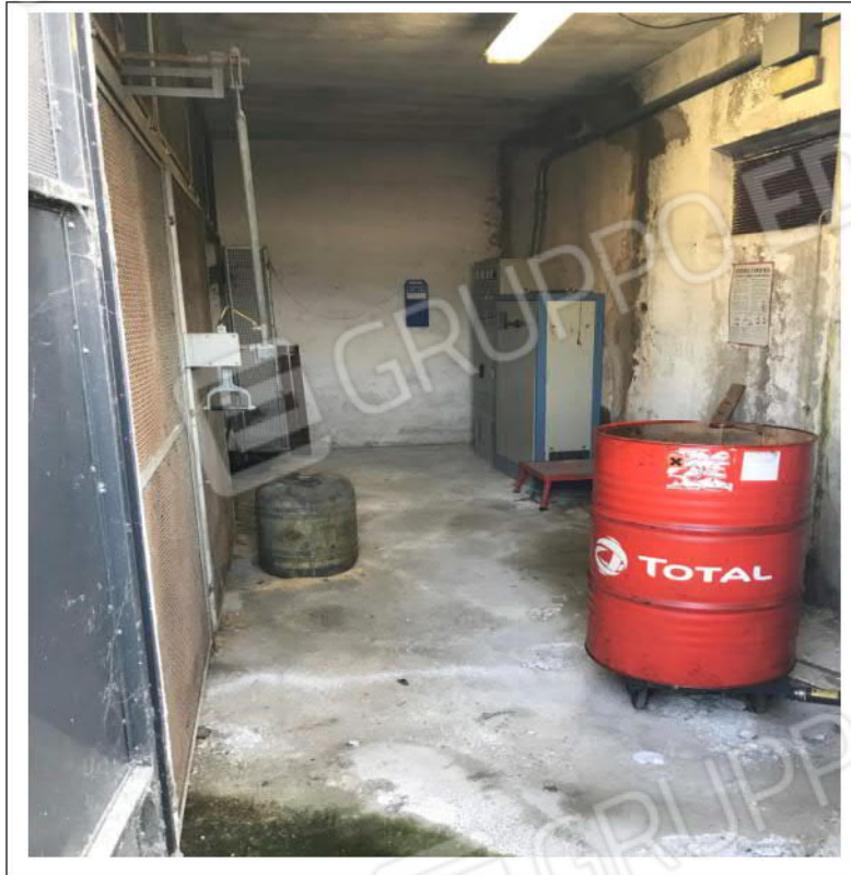
14) Fotografia che inquadra l'interno della cabina elettrica posizionata a fianco del FABBRICATO B
