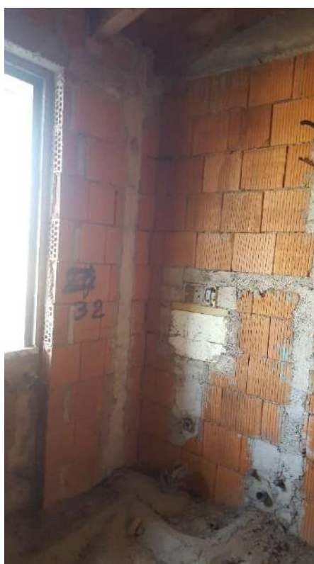
Vista bagno piano primo con cassetta wc ed attacchi sanitari
