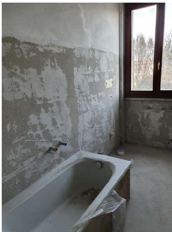
Vista bagno: vasca da bagno ed attacchi sanitari
