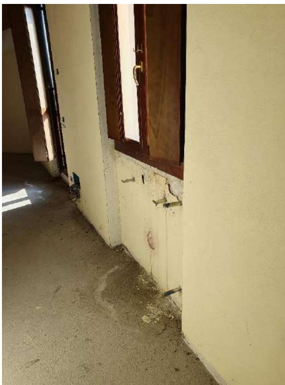
Soggiorno- attacchi per impianto a calorifero
