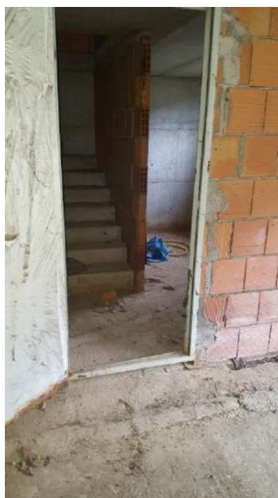
Vista collegamento tra sub. 9 e sub. 46
