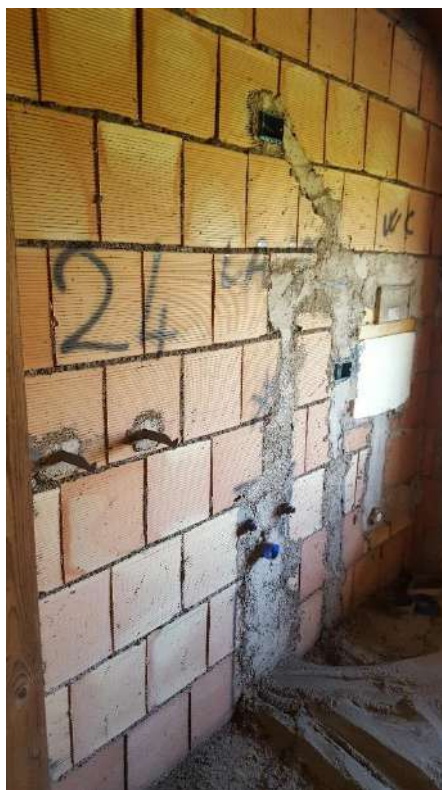
Bagno con scarichi ed attacchi sanitari
