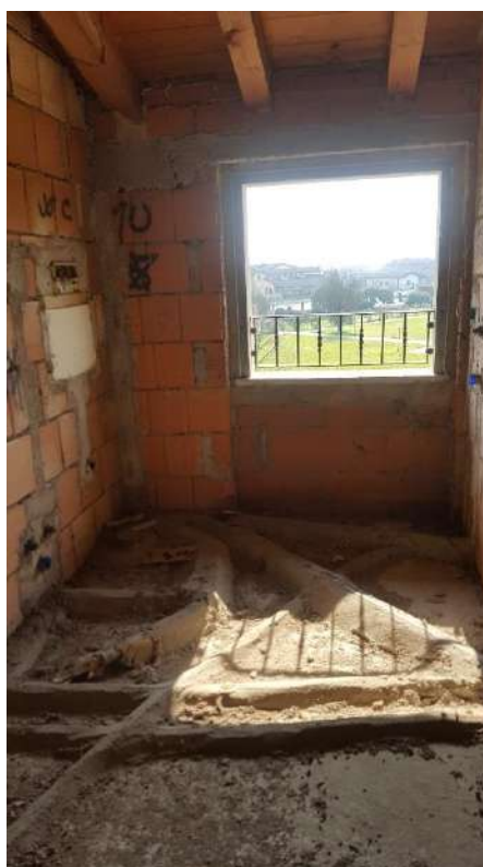
Bagno – Cassetta wc, attacchi sanitari
