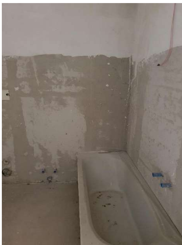
Vasca bagno ed attacchi per sanitari
