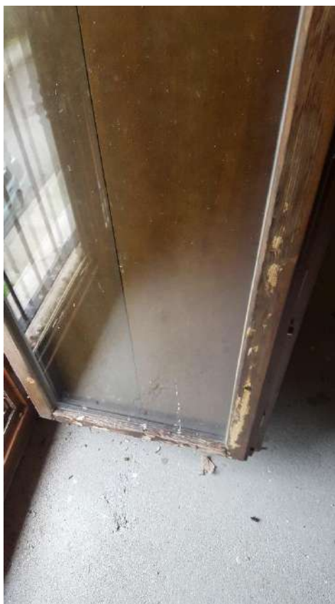
Dettaglio serramento: stato d'usura
