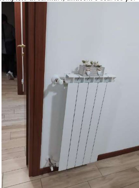
Impianto di riscaldamento autonomo con caloriferi in alluminio
