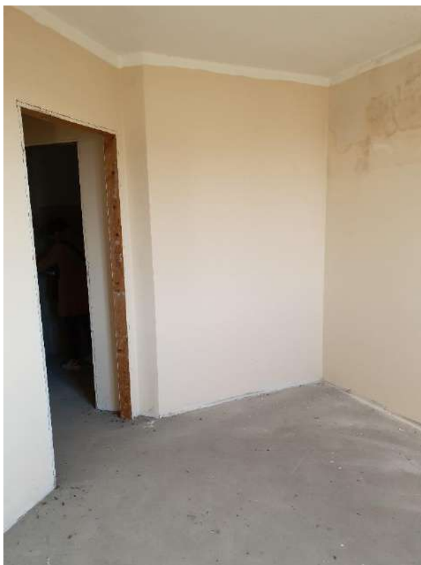
Umidità presente sulla parete della camera da letto
