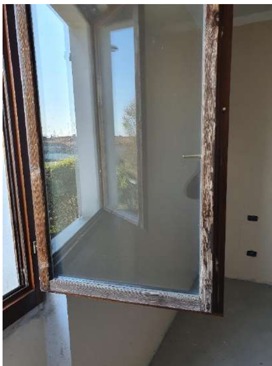
Dettaglio serramento: forte degrado delle finiture
