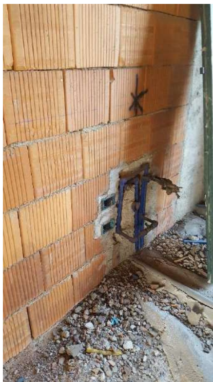
Vista cucina con attacchi e scarico
