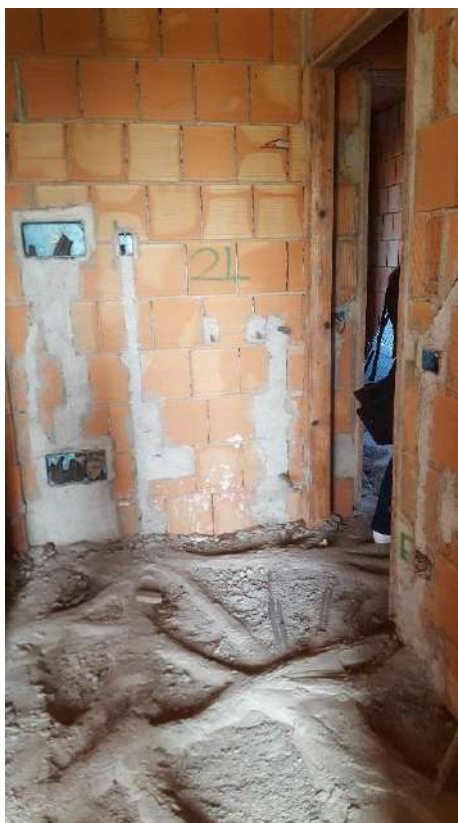
Distribuzione delle canalizzazioni e predisposti attacchi per impianti
