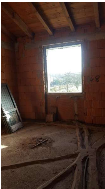
Vista camera e tracciato impianto elettrico
