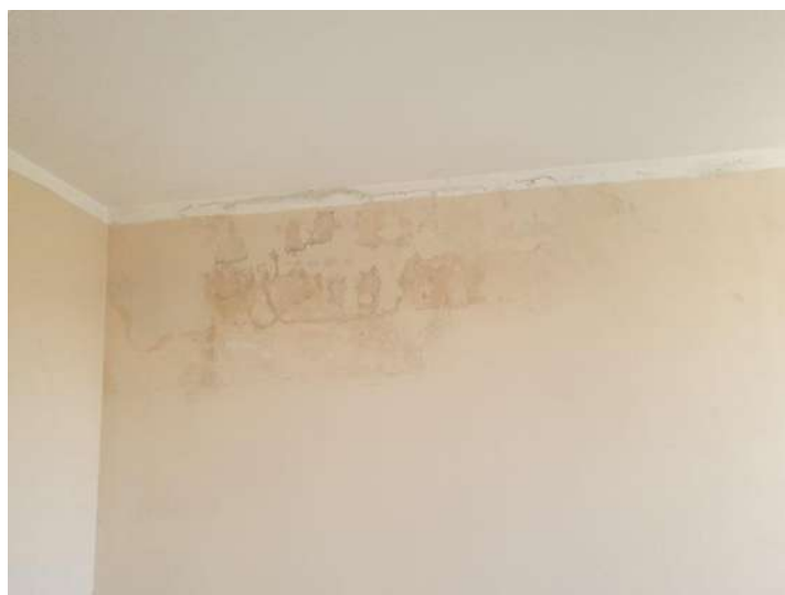
Dettaglio umidità presente sulla parete della camera da letto
