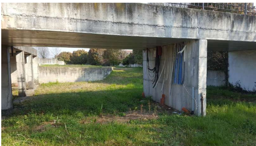
Sottopasso del viale ingresso (sub 71 ) strutture al piano interrato del fabbricato tipo B tra il sub 59 e sub 58
