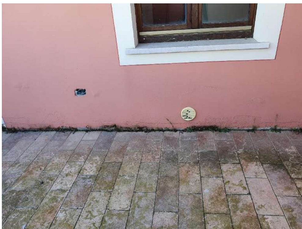
Terrazza scoperta- vegetazione spontanea ed impermeabilizzazione degradata
