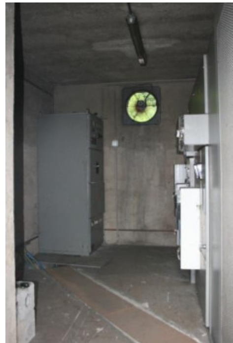
Piano terra: interno cabina elettrica
