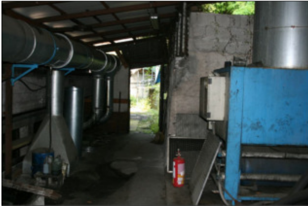
1 - TETTOIA CANALI IMPIANTI
