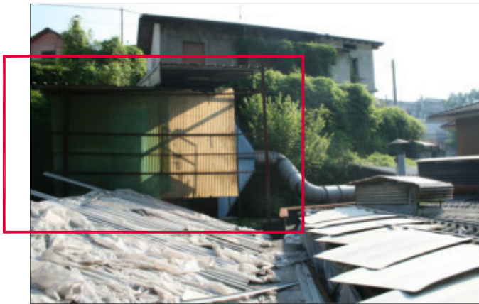
2 - TETTOIA CANALI IMPIANTI
