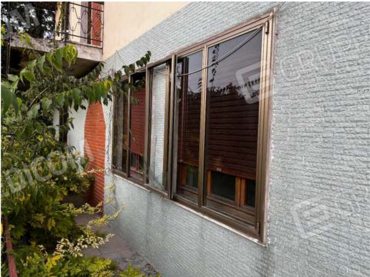
SERRAMENTO ESTERNO ROTTO
