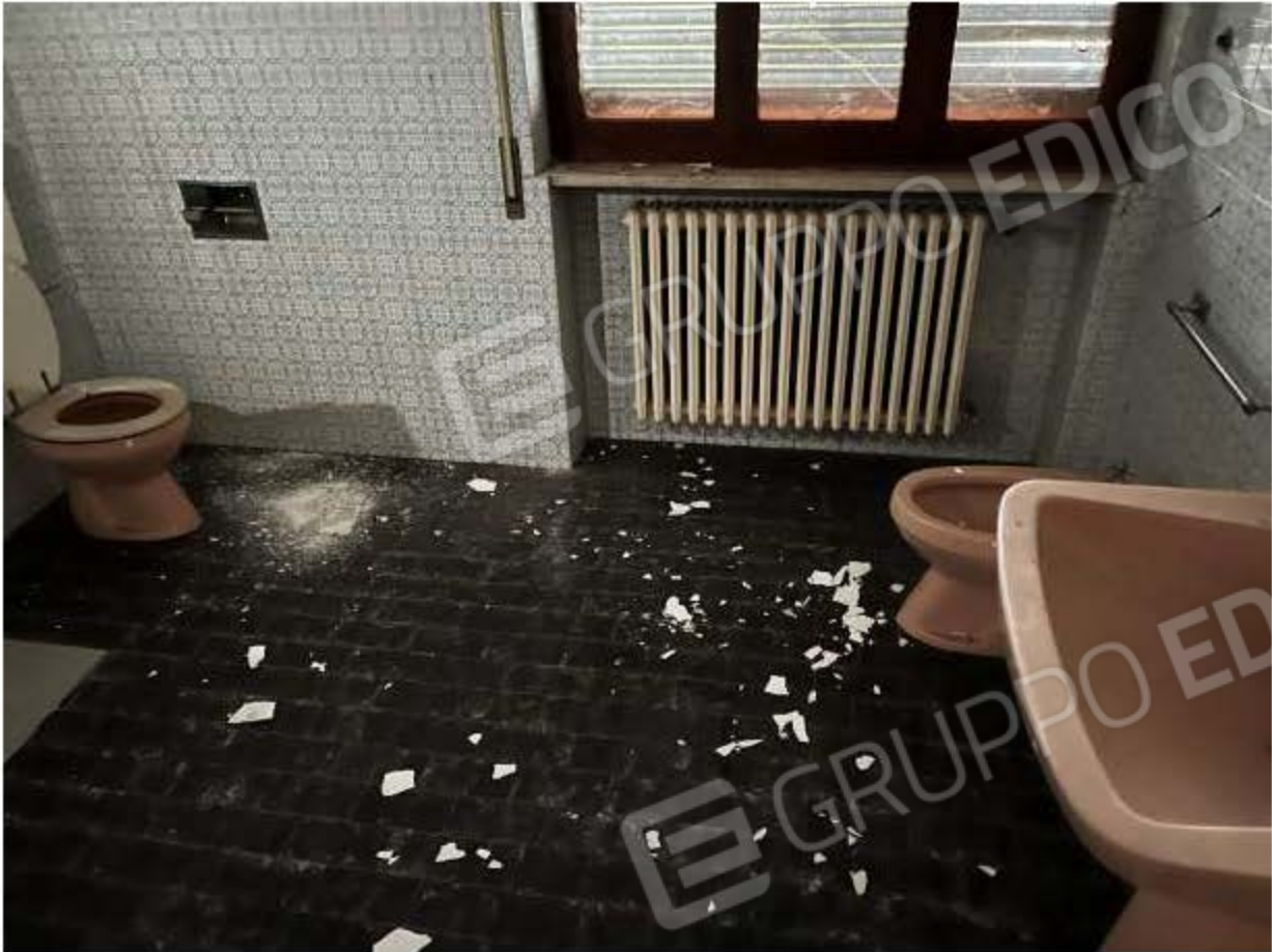
DISTACCO DELLA TINTEGGIATURA DAL SOFFITTO
