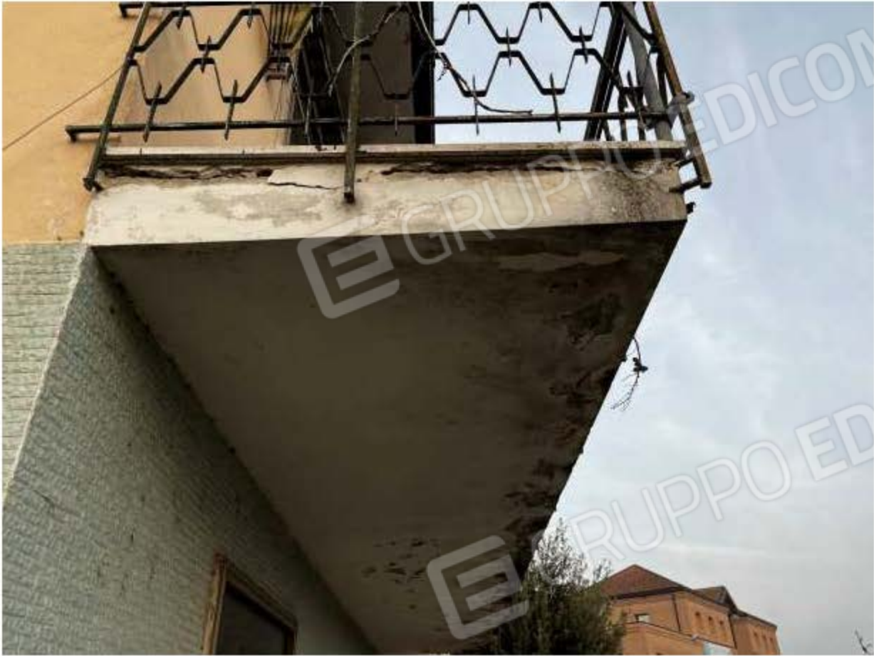
DANNI AL BALCONE
