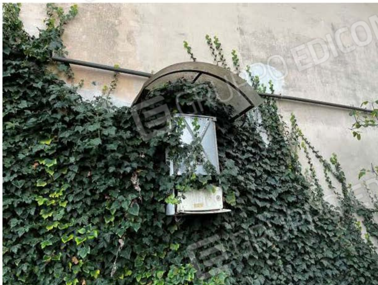
CALDAIA ESTERNA COPERTA DAL VERDE
