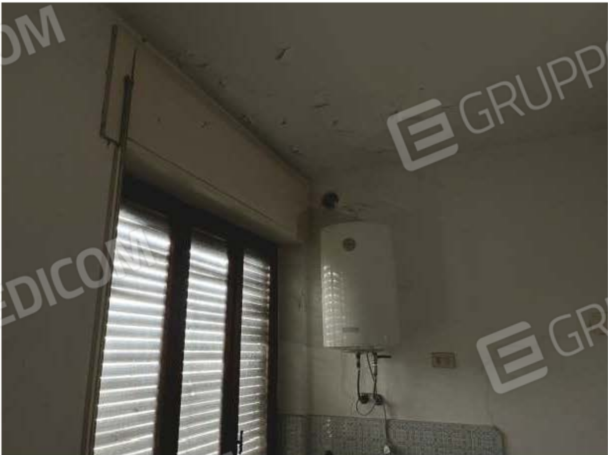
DISTACCO DELLA TINTEGGIATURA DAL SOFFITTO
