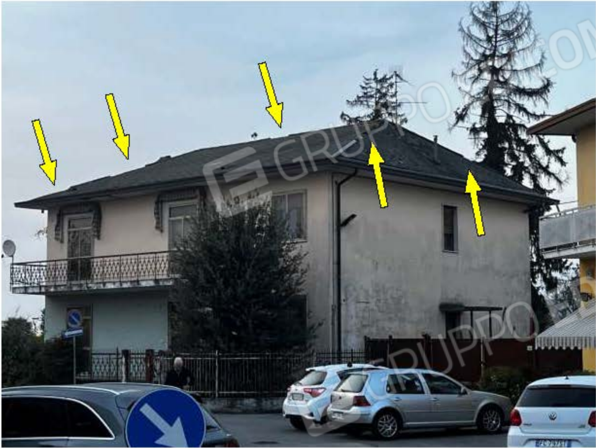
DANNI ALLA COPERTURA
