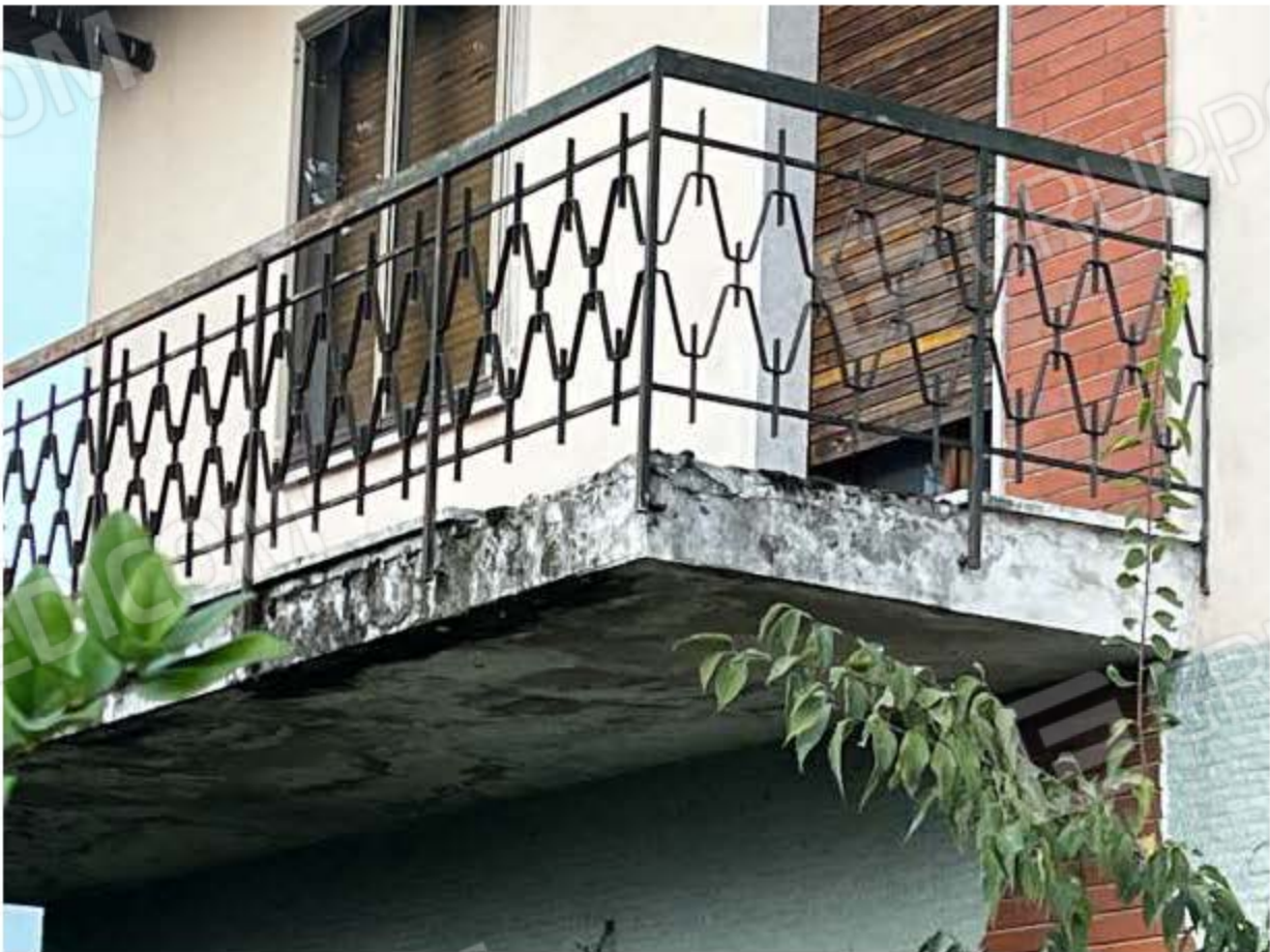
DISTACCO DELLA PAVIMENTAZIONE DEL BALCONE
