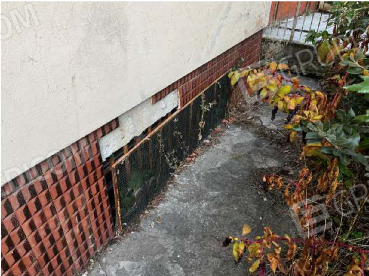
DISTACCO DEL RIVESTIMENTO ESTERNO
