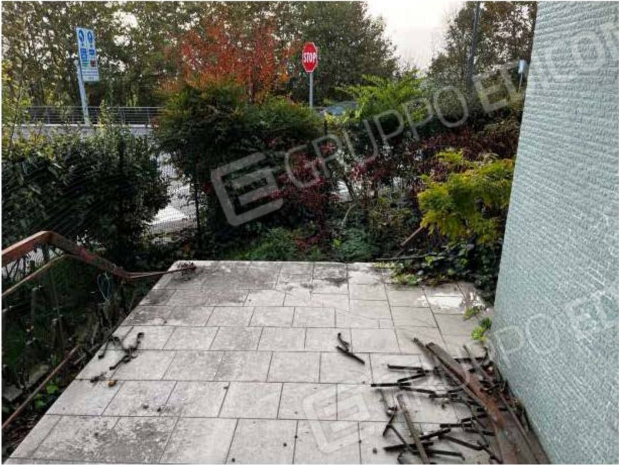
DANNI BALLATOIO DEL PIANO TERRA
