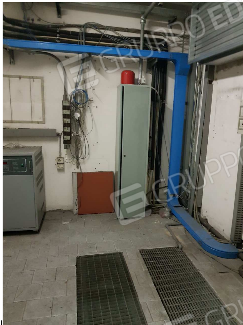
Locali al piano interrato – zona impianti
