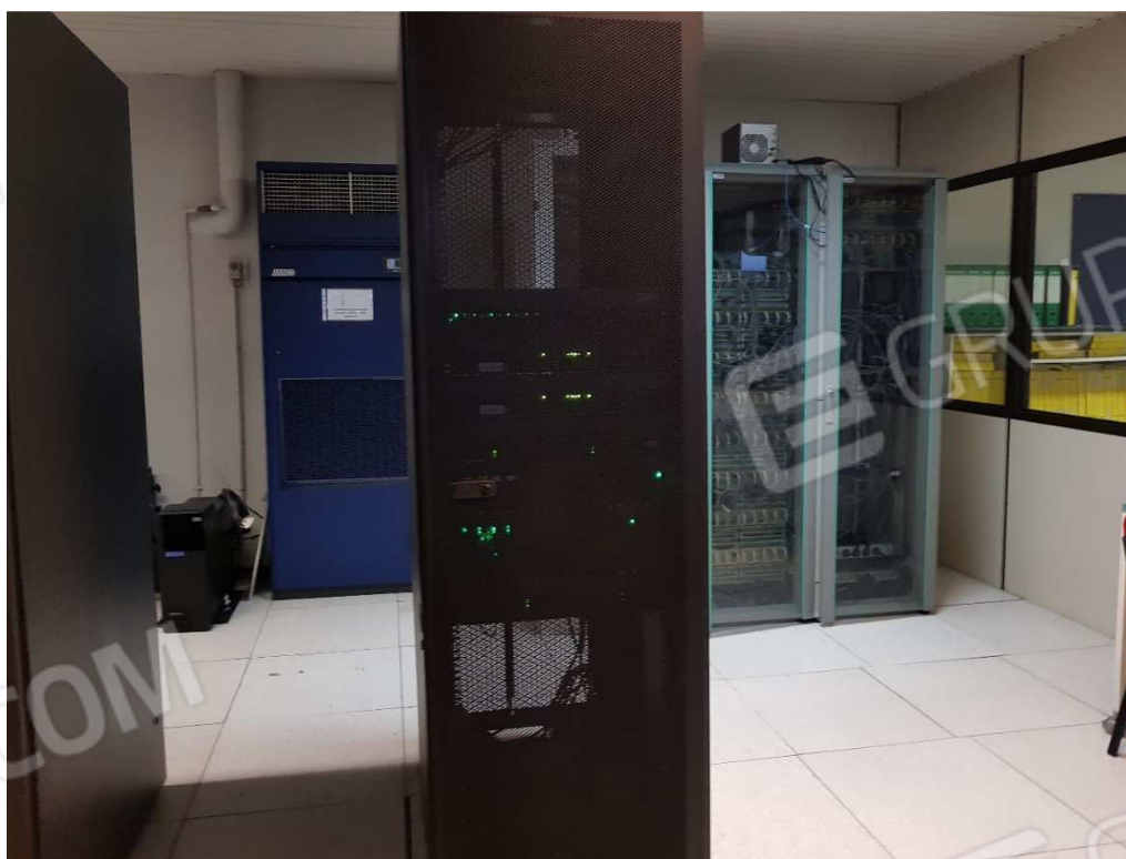
Centro elaborazione dati al piano interrato
