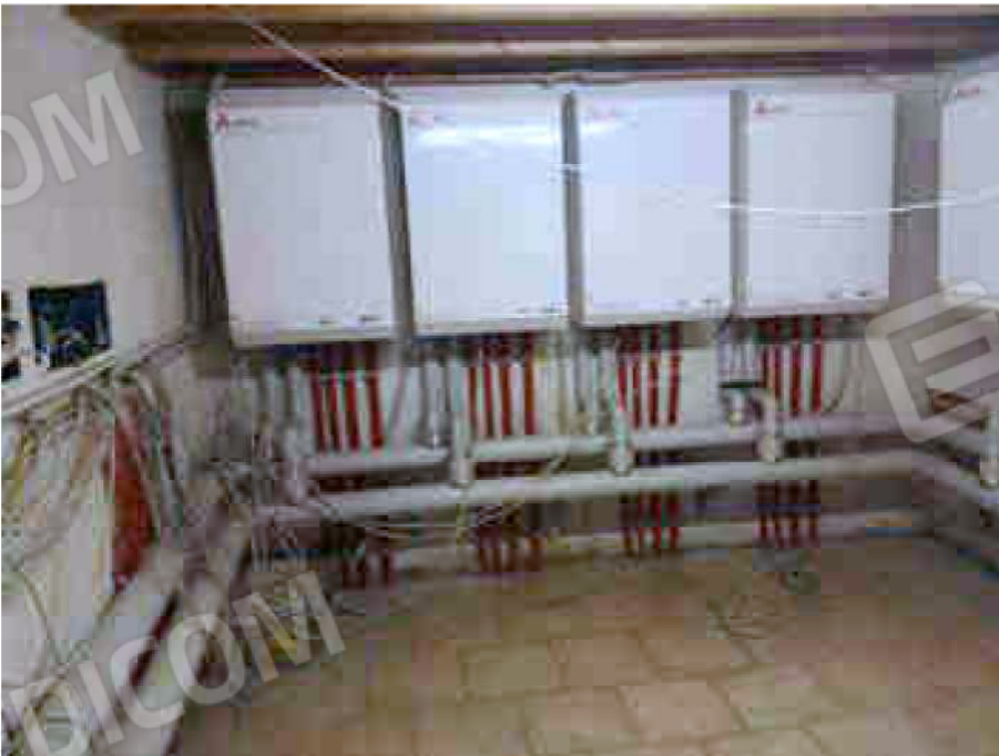
Fotografia 8 – Parti comuni sub.18 – Centrale Termica Teleriscaldamento
