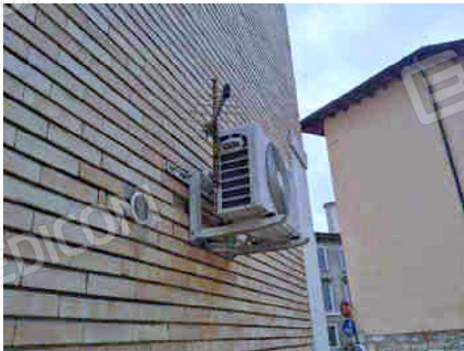
Fotografia 46 – Lotto 8 di 8 – Sub. 26; unità esterna.
