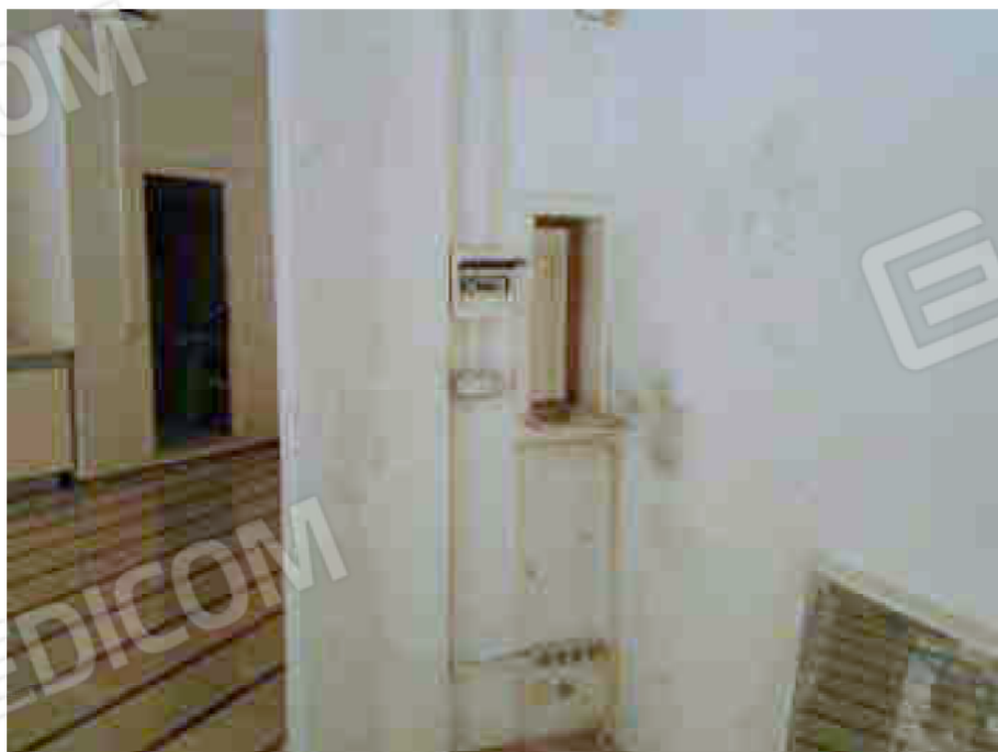
Fotografia 42 – Lotto 8 di 8 – Sub. 26.
