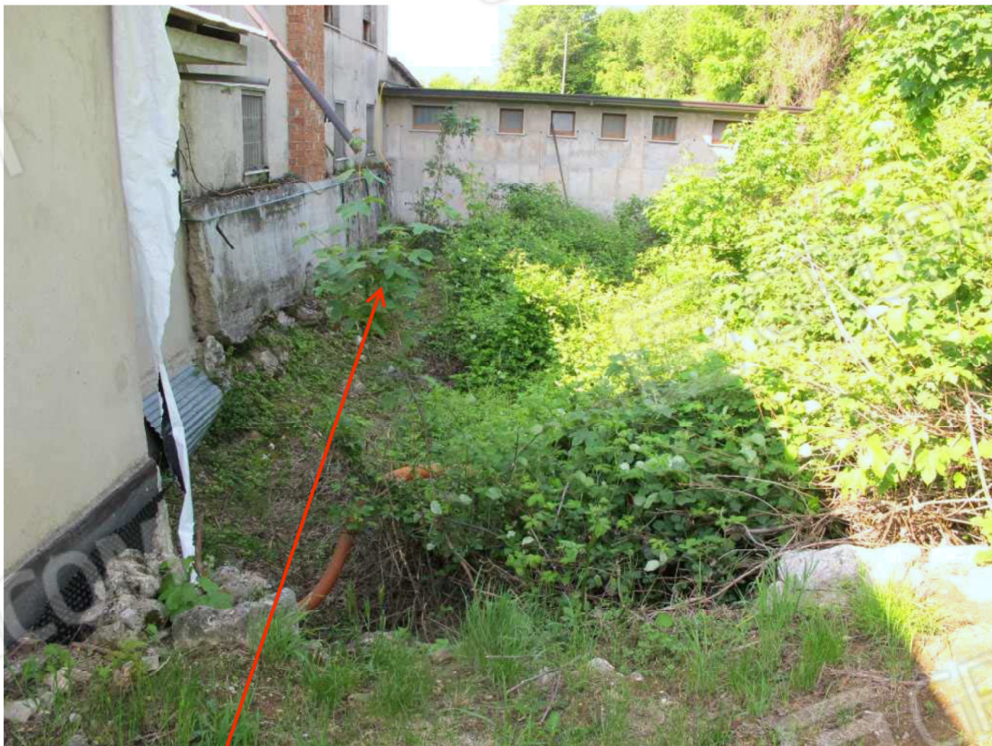
Riempimento del terrapieno difforme alle pratiche edilizie
