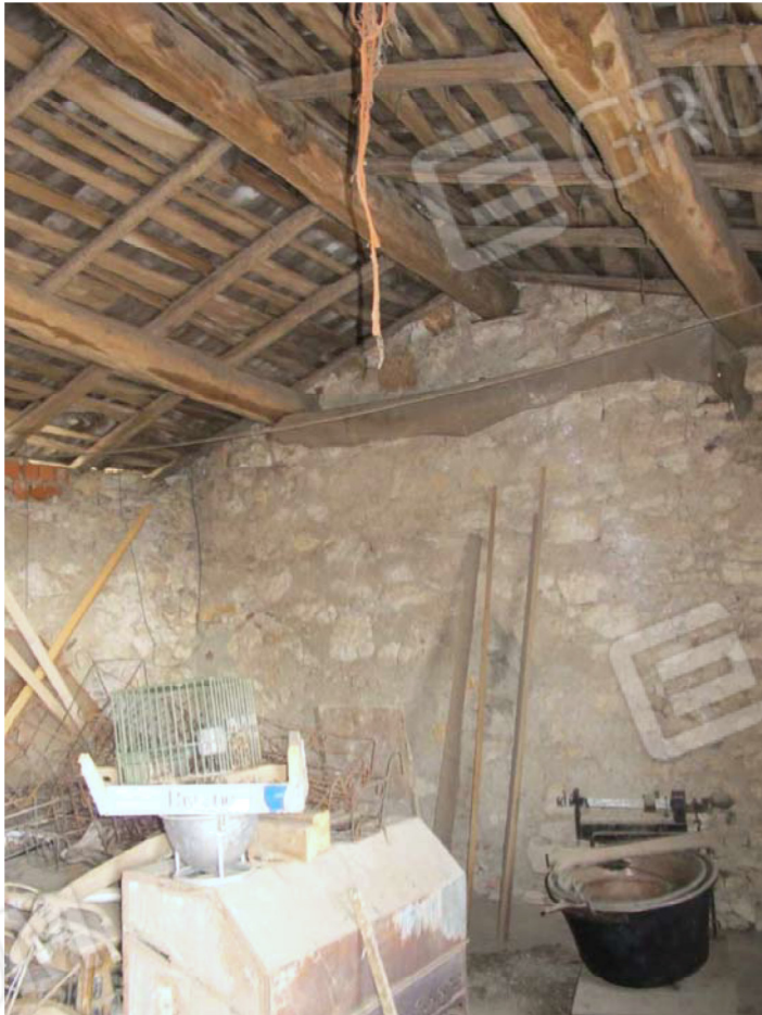
Camera con pavimento sfondellato
