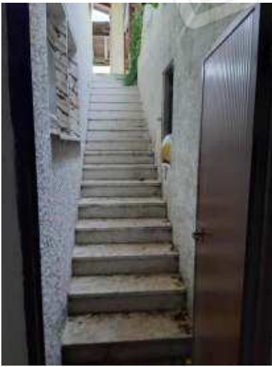
Scala di collegamento appartamento piano primo sub 13 con disimpegno posto al piano terra di uso esclusivo.
