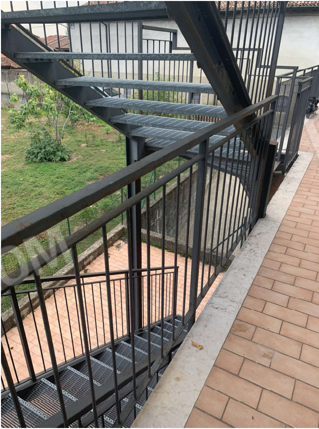
Scala di accesso comune e esterno del fabbricato con le nicchie dei contatori
