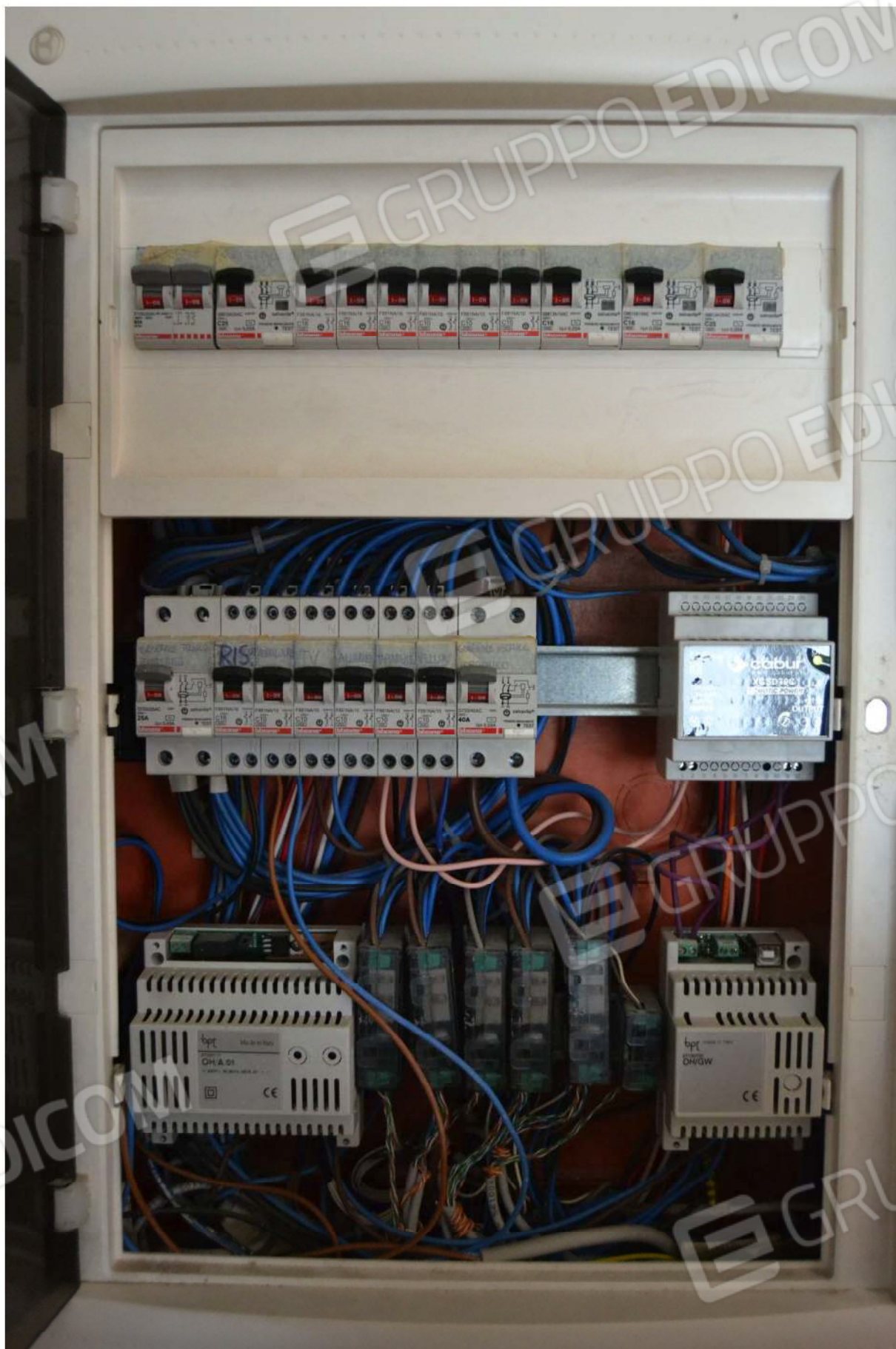
QUADRO ELETTRICO GENERALE
