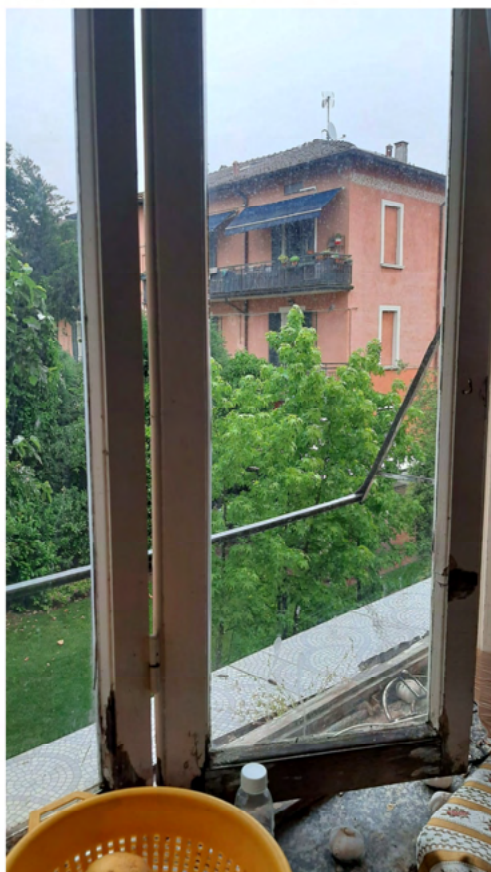
FOTO 13: SERRAMENTI ESTERNI DA MANUTENERE
