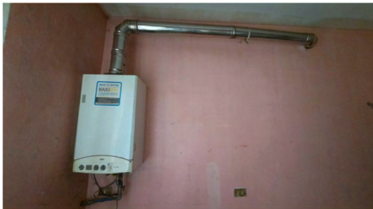
FOTO 11: CALDAIA IN CUCINA CON CANALE FUMI (ATTENZIONE, DA VERIFICARE A CURA DI TECNICO MANUTENTORE SPECIALIZZATO)
