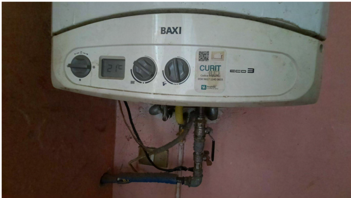
FOTO 12: DETTAGLIO COLLEGAMENTI IMPIANTISTICI DELLA CALDAIA E TARGHETTA CURIT (IMPIANTO DA VERIFICARE)
