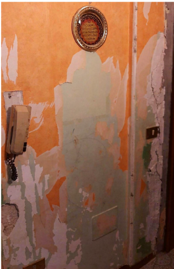
FOTO 4: CITOFONO E MURI AMMALORATI
