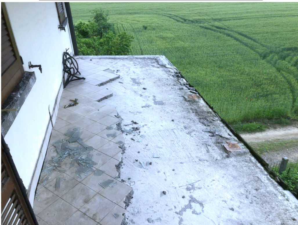
BALCONE PERICOLANTE E PRIVO DI PARAPETTO
