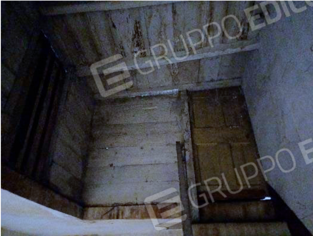
Ingresso al solaio dalle scale - pericolante
