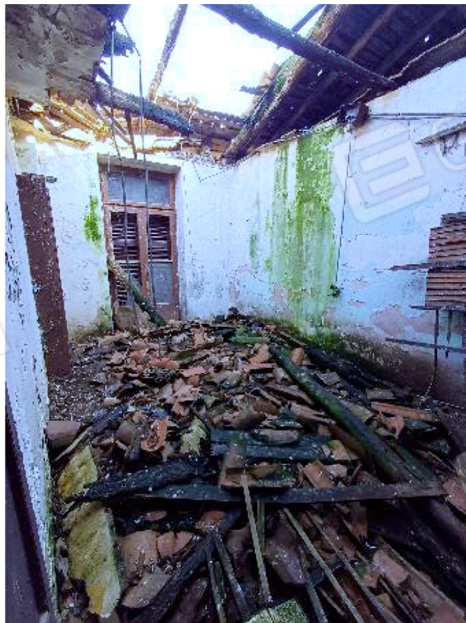
Sub.7 P1 - Porzioni crollate e pericolanti
