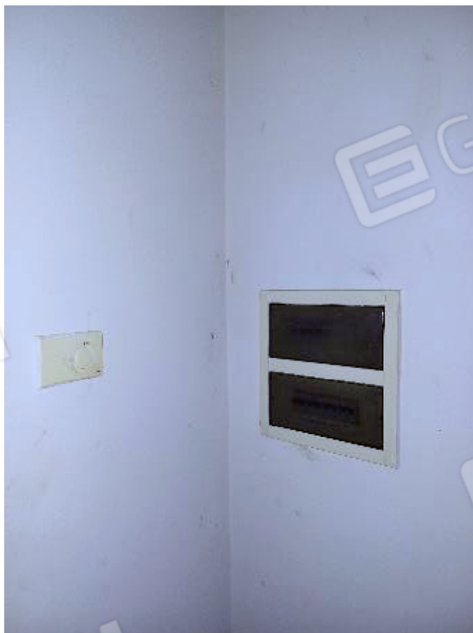
Quadro elettrico e termostato ambiente
