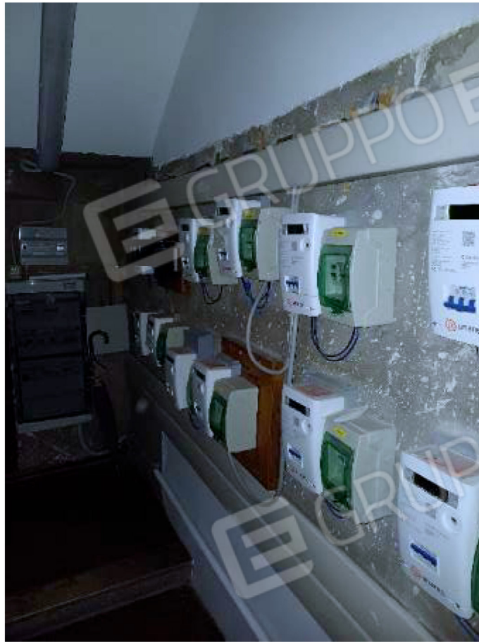
contatori in vano comune sottoscala condomino
