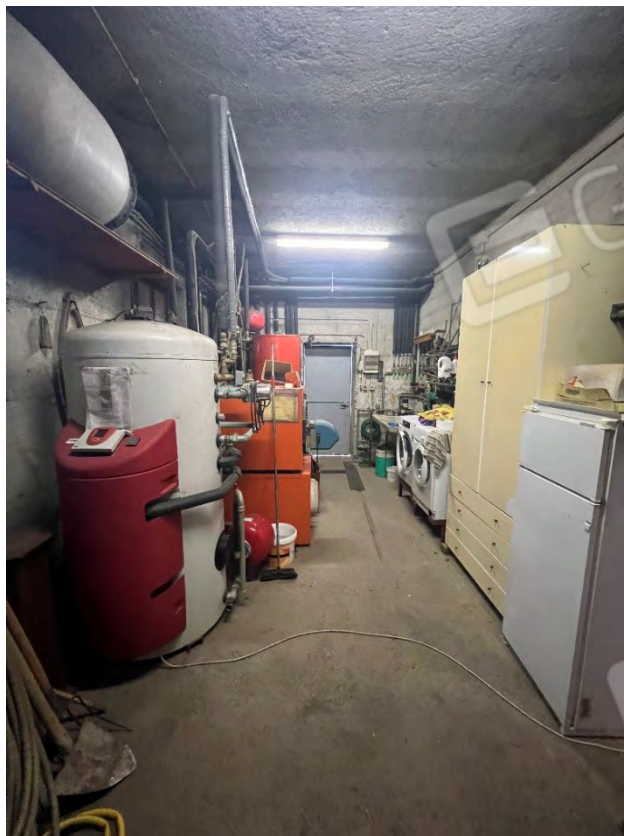
Parte comune – centrale termica
