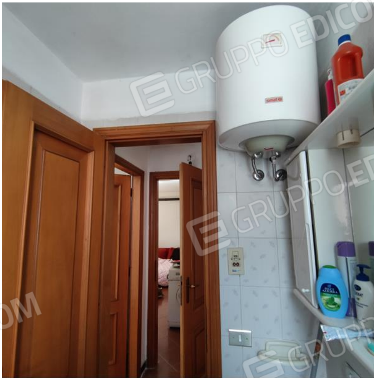
FOTOGRAFIA N.13 -IL BAGNO VERSO IL LATO OVEST- E BOILER ELETTRICO
