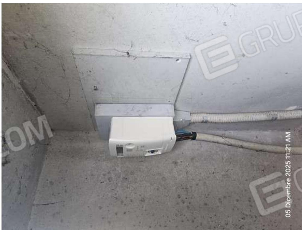
Fotografia D.24 - Punto di fornitura energia elettrica
