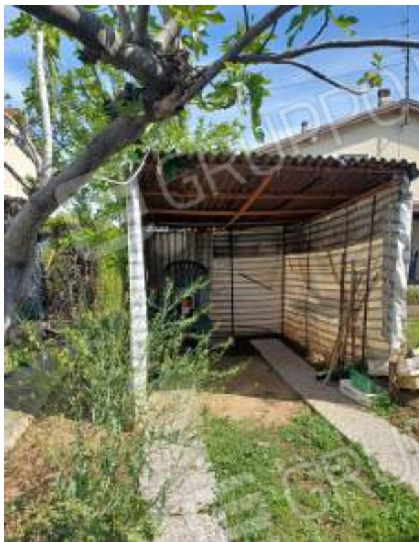
05-Manufatto abusivo da rimuovere
