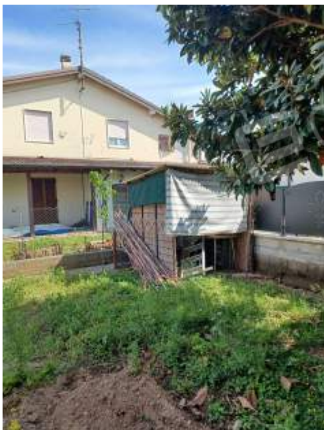
06-Manufatto abusivo da rimuovere
