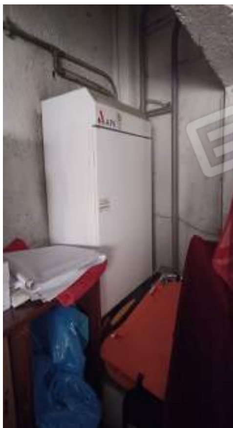
14-Scambiatore di calore
