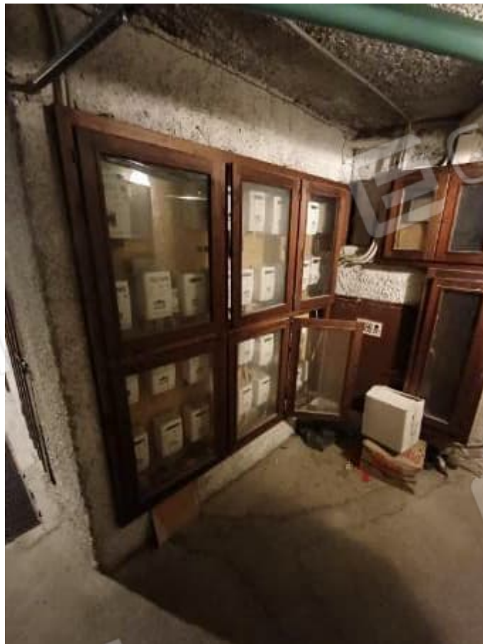
Accesso comune alle cantine – zona contatori
