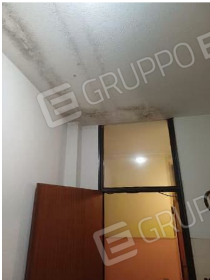
Muffe da ponte termico in cucina
