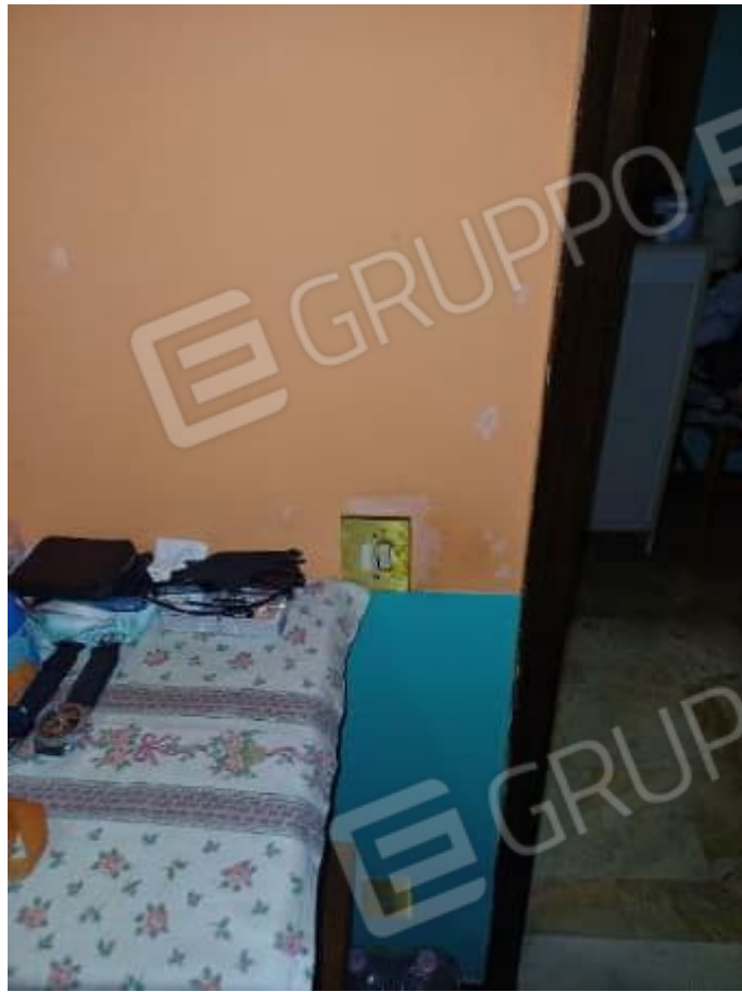
Impianto elettrico originario periodo di costruzione
