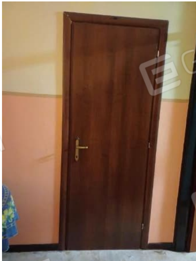
Porta nella parete divisone soggiorno/atrio - abusiva
