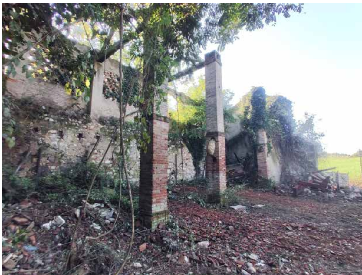
Particolare fabbricato accessorio cadente
