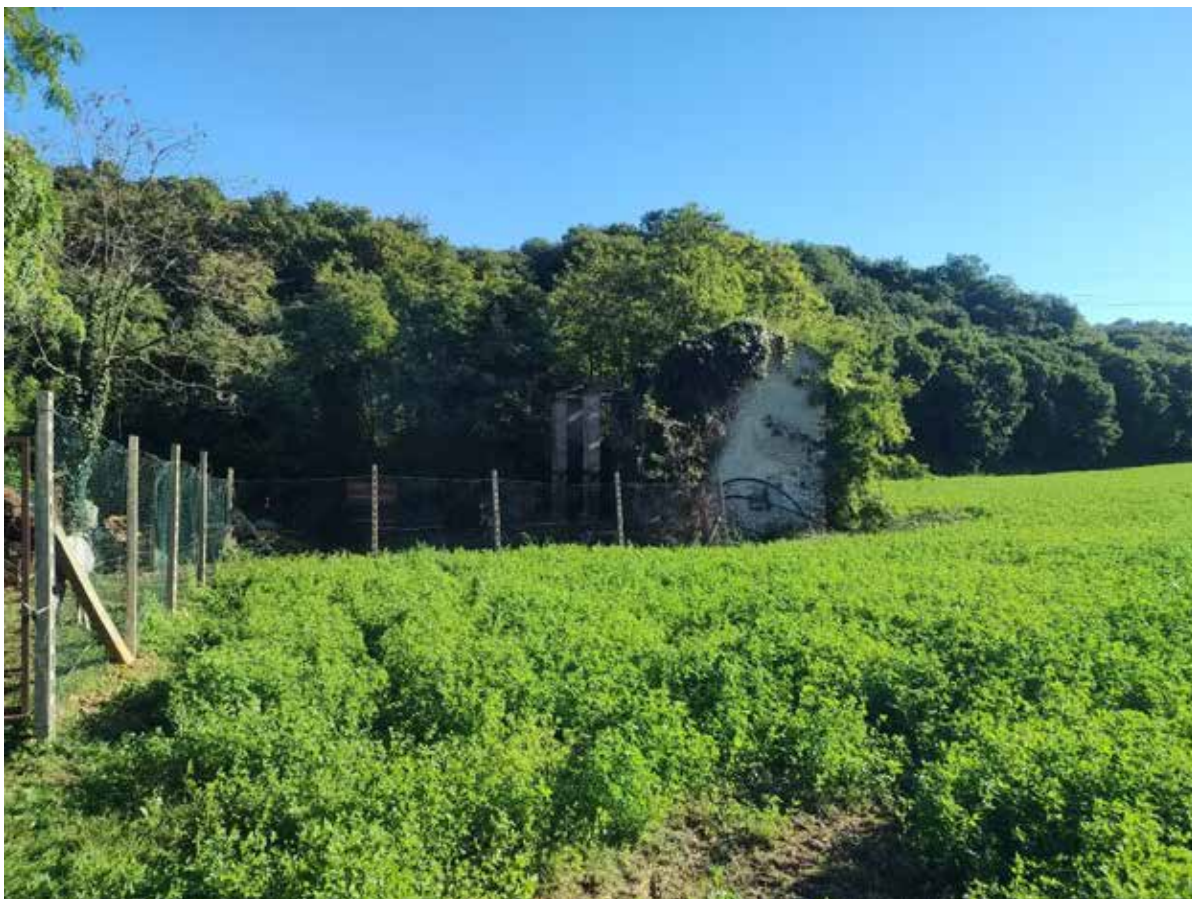
Vista lato sud del fabbricato accessorio cadente
