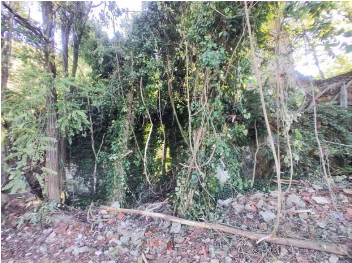
Vista lato sud del fabbricato residenziale principale ridotto a cumulo di macerie, inglobato nella folta vegetazione spontanea
