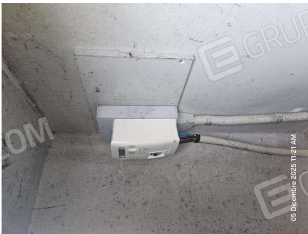
Fotografia D.24 - Punto di fornitura energia elettrica
