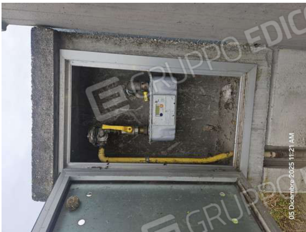
Fotografia D.23 - Punto di fornitura gas
