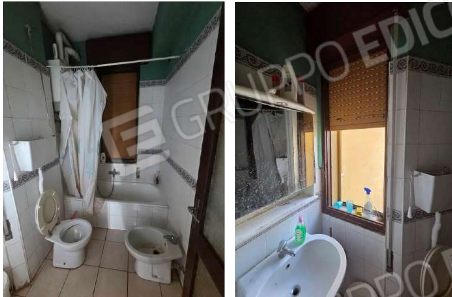
Figura 13 – Vista interna del bagno. Come si può notare le due finestre non sono dotate di serramenti ma solamente delle tapparelle
