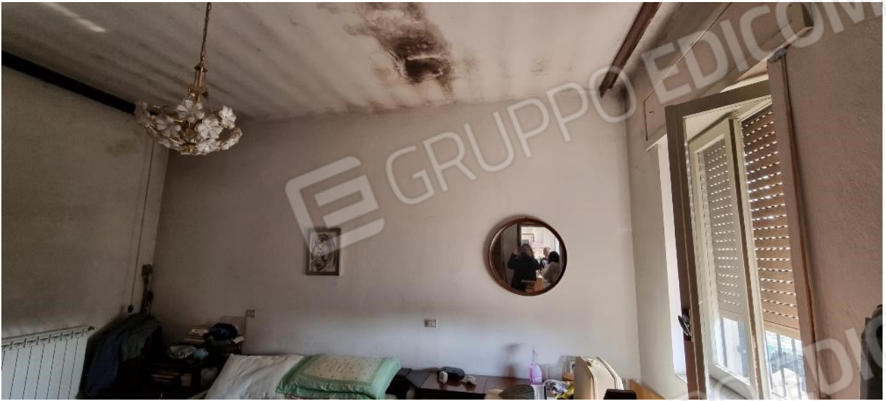
MACCHIE DI MUFFA SUL SOFFITTO CAMERA
