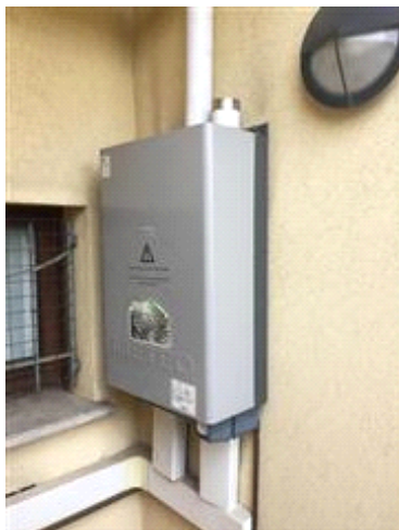
caldaia impianto autonomo di riscaldamento
