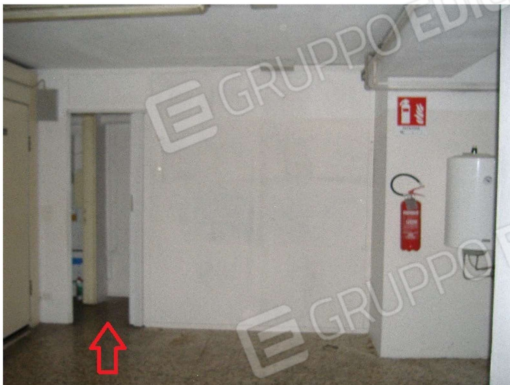
P.S1 (partizione verticale e porta non indicata negli elaborati grafici in atti)
