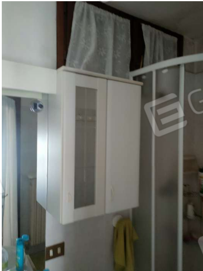
(finestra bagno, oggetto di sanatoria)
