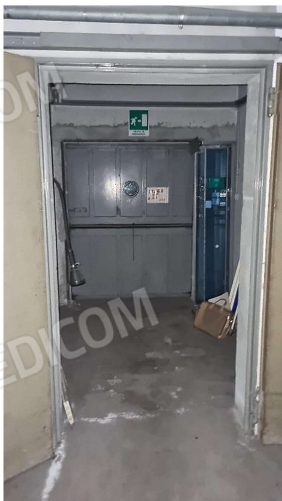
MONTACARICHI PIANO INTERRATO (MAGAZZINO)
