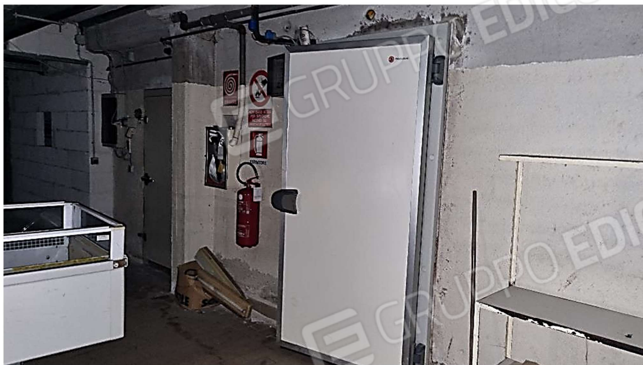
CELLE FRIGORIFERE MAGAZZINO PIANO INTERRATO
