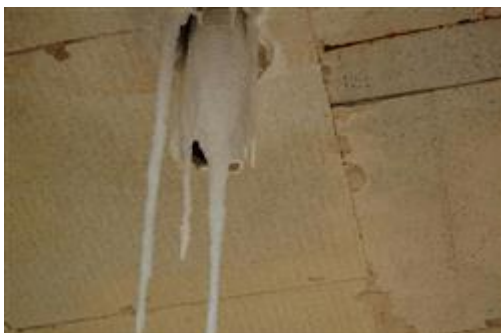
infiltrazioni solaio di copertura
