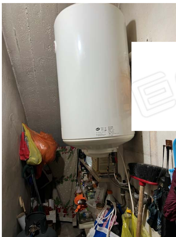
Boiler nel sottoscala
