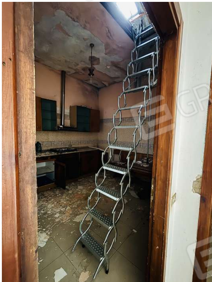
Fotografia 39. Lotto B. Botola di accesso al sottotetto.
