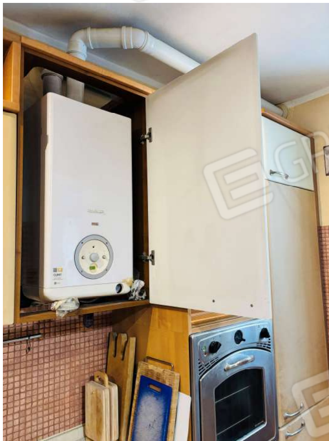
Fotografia 17. Piano Terra. Cucina. Particolare caldaia.
