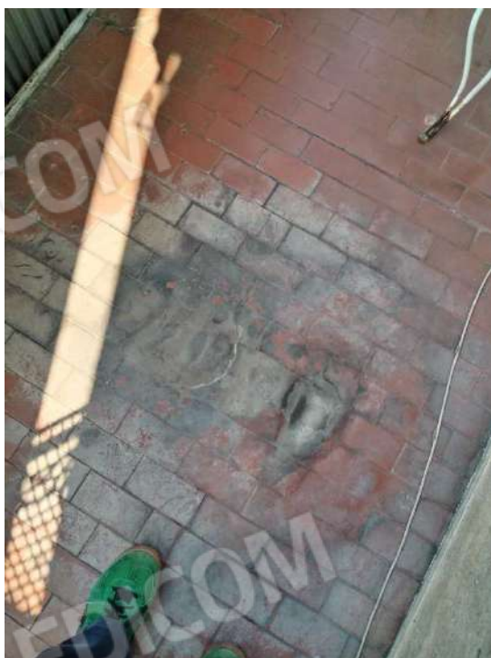
12) Pavimentazione (un po' usurata) del balcone,
