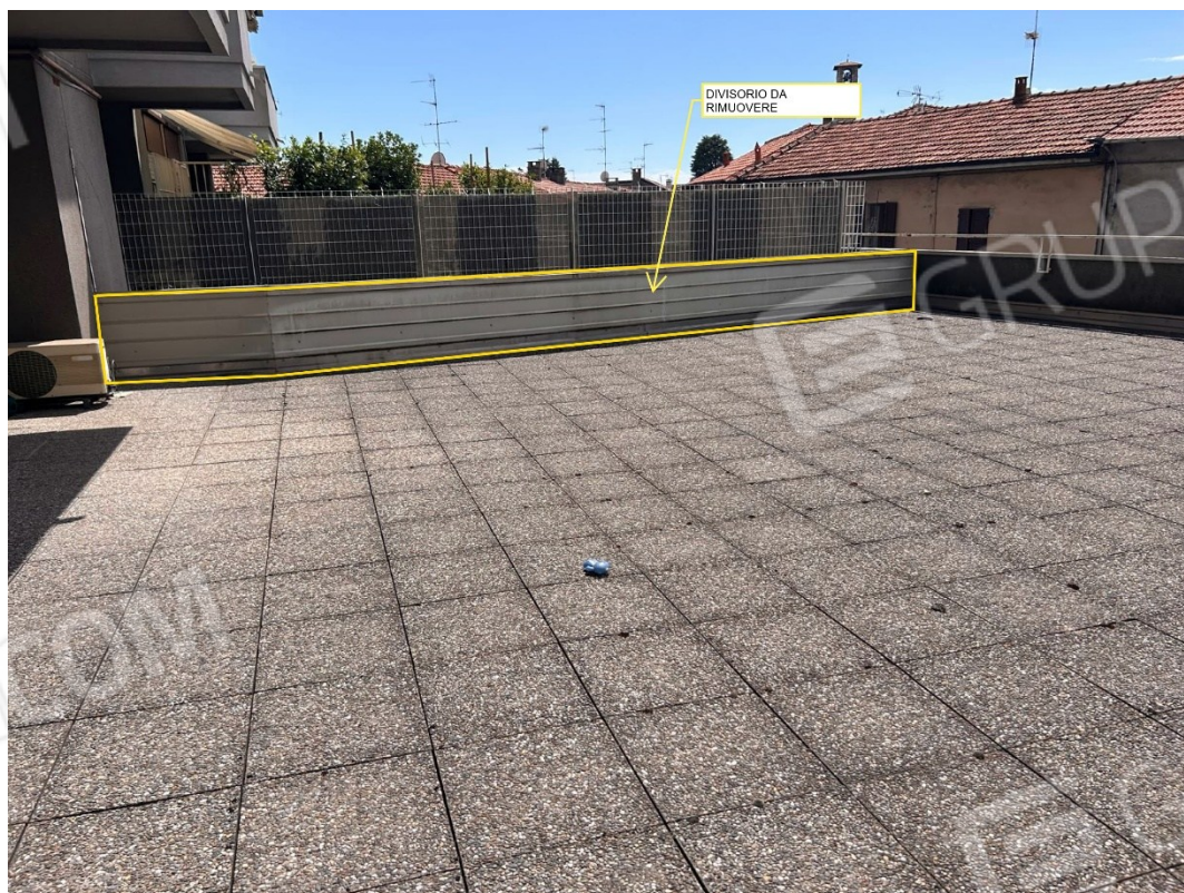
Foto 10 - TERRAZZO CON DIVISORIO DA RIMUOVERE
