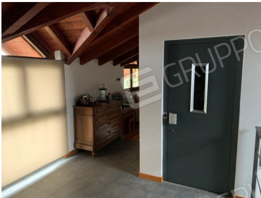
09 ascensore interno sbarco al piano secondo
