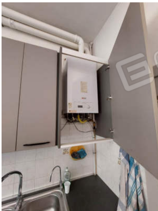
FOTO 12 Vista interna P2 – Caldaia per riscaldamento e Acqua Calda Sanitaria
