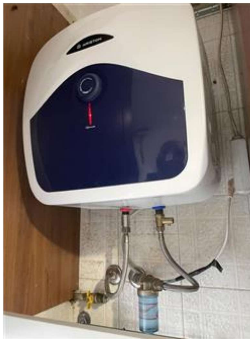
boiler elettrico per la produzione di acqua calda sanitaria
