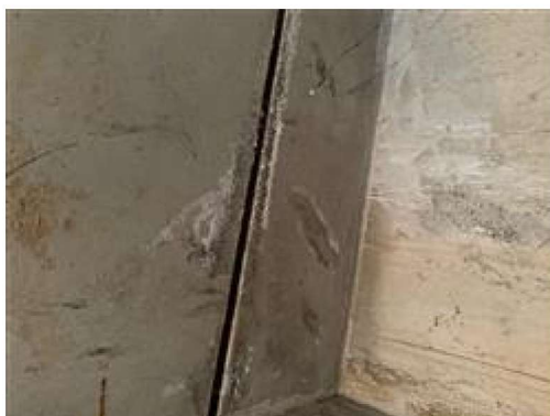
Umidità riscontrata su intradosso soletta
