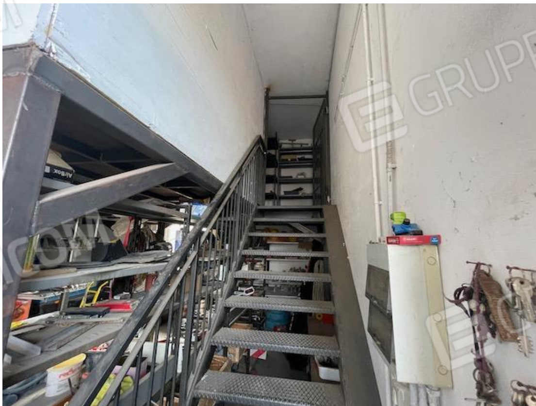
Scala di Accesso al soppalco non autorizzato
